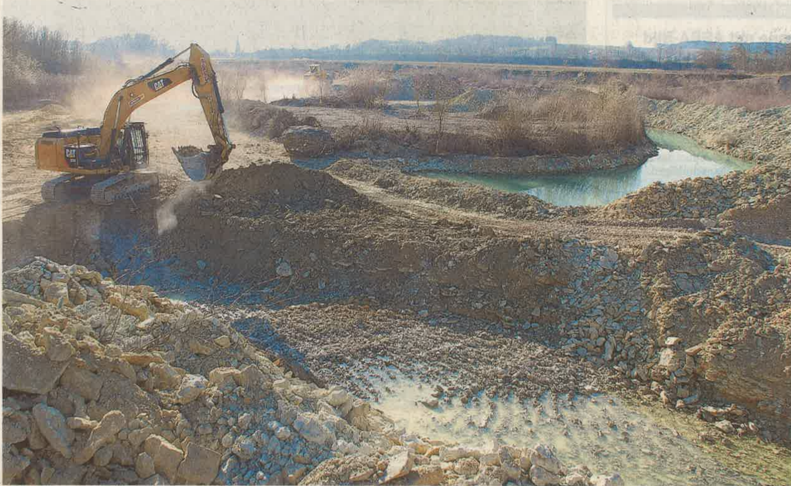
Im wahrsten Wortsinn steinharte Arbeit ist es für Tobias Hilt im Kettenbagger (vorne) und Laderfahrer Alfons Büglmeier (Hintergrund), das steinige Gelände neu zu modellieren. Fotos: Hutzler
